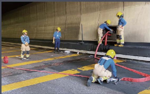
▲ 專隊於紅磡海底隧道檢查及測試消防栓。
