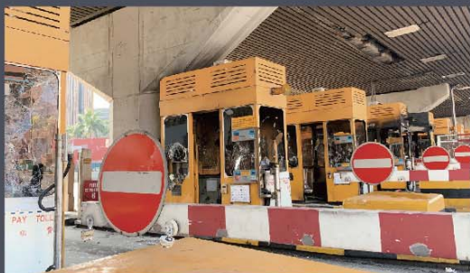
▲ 紅磡海底隧道設施受到破壞而封閉。
