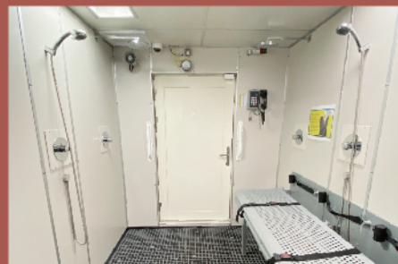
完善的洗消設備。 Well-equipped decontamination facilities.
