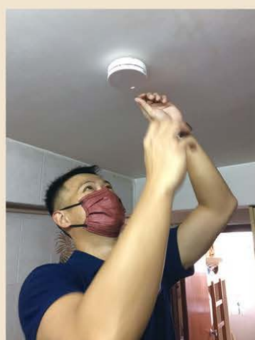
▲ 大澳消防局消防人員在工餘時間為大澳長者安裝獨立火警偵測器及提供防火教育。
