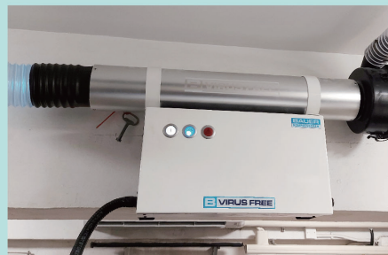
九龍呼吸器室的空氣壓縮系統，加設防護過濾器，可提升呼吸器空氣質素。
