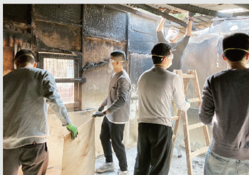
消防處義工隊協助移除平房有倒塌危險的部分和清理雜物。
