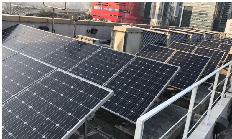
安裝於啟德消防局天台的太陽能光伏板
