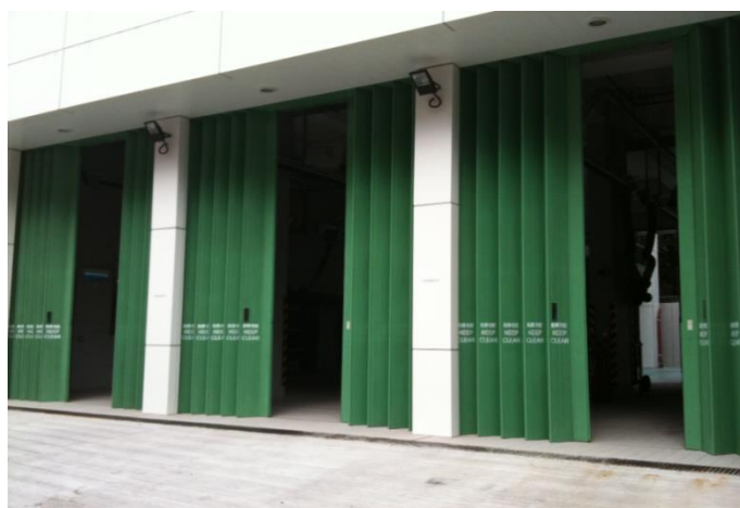
設有變速驅動裝置的救護站摺閘
