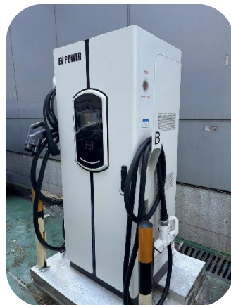
於尖東消防局安裝的電動車輛充電設施
