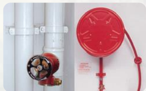
消防栓及喉轆系統
