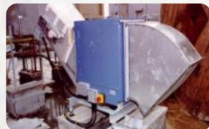
機械通風系統自動中斷操作裝置
