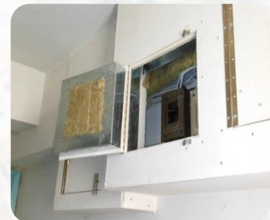
非緊急設施圍封物
