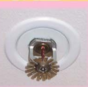
花灑系統 Sprinkler System
