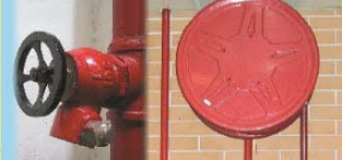
消防栓 / 喉轆系統 Hydrant / Hose Reel System
