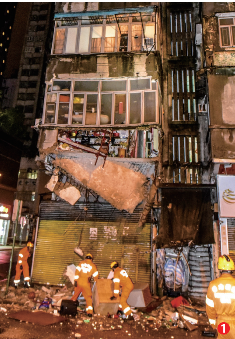
1 紅磡一幢唐樓的露台倒塌，坍塌搜救專隊搜索被困人士(星島日報圖片)。
