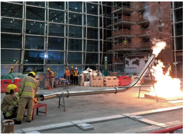
d. 消防處人員於機場一號客運大樓擴建部分進行檢驗巡查，確保其消防裝置及設備的安裝符合規格及運作正常。
