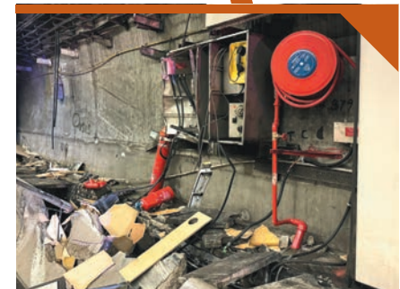
▲長青隧道管道內發生交通意外，消防設施損毀嚴重。
