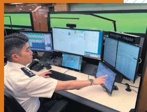
▲設於消防通訊中心內的第四代調派系統控制台。
