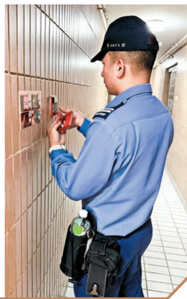
▲消防人員檢查樓宇的消防警鐘系統。
