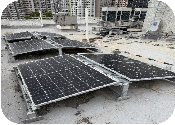
于葵涌消防局安装的太阳能光伏板
