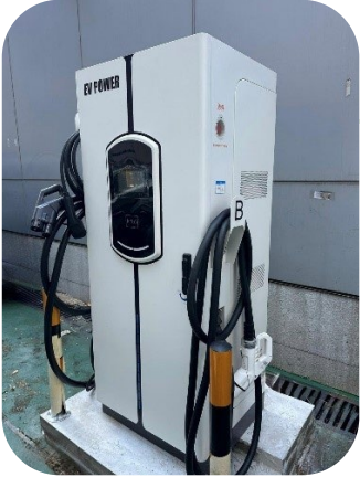
于尖东消防局安装的电动车辆充电设施
