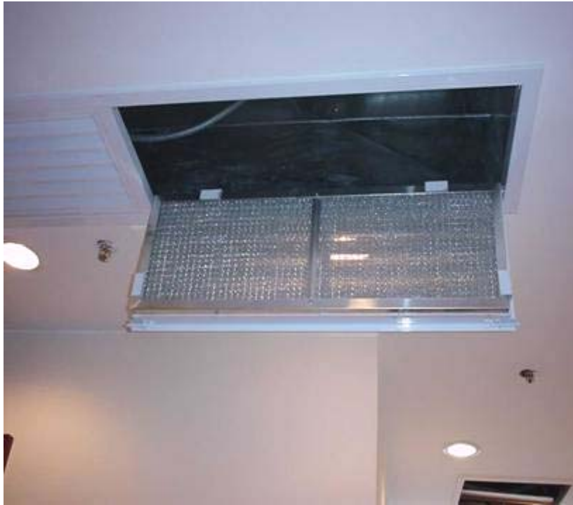
通風管道內的金屬隔塵網
