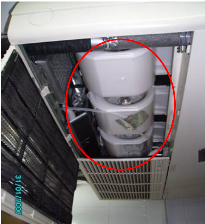
通風管道內有易燃物料(鼓風機的塑膠外殼)
