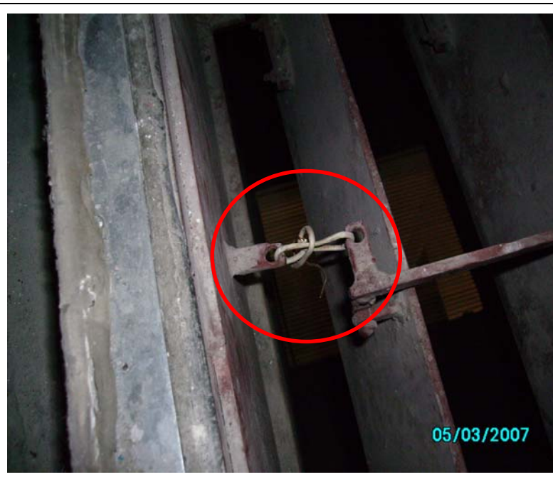
以鐵線或並非消防處認可的保險連杆連接防火閘
